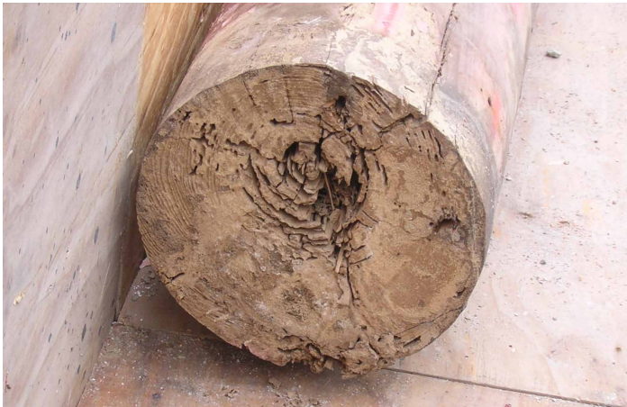
木標桁遭到白蟻破壞。由於白蟻有時食用內部木材，而外部看來無問題，可能難以察覺白蟻感染
