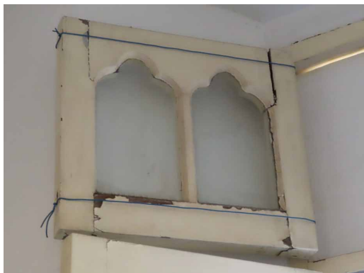
頂部通風口的木框移位
