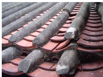
(上) 山脊附近的筒瓦出現橫向裂縫
