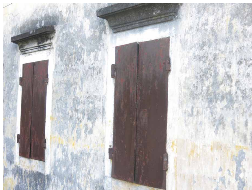
金屬窗子上的油漆剝落
