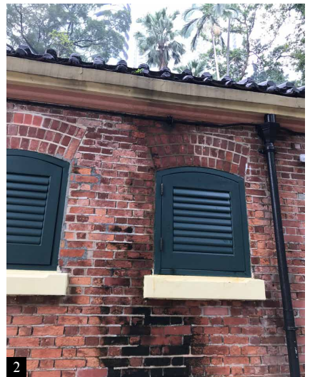
1. 牆身底部的深色污跡是因為長出藻類造成。這是牆身潮濕的跡象。水分的成因可能是濕度上升或雨水從硬地面飛濺。
