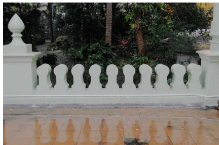
由於排水渠和落水管堵塞，導致屋頂水浸
