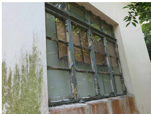
金屬窗框上的油漆剝落
