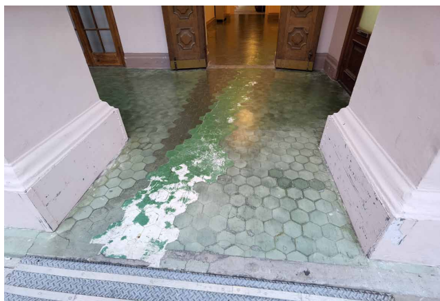
地磚老化和磨損
