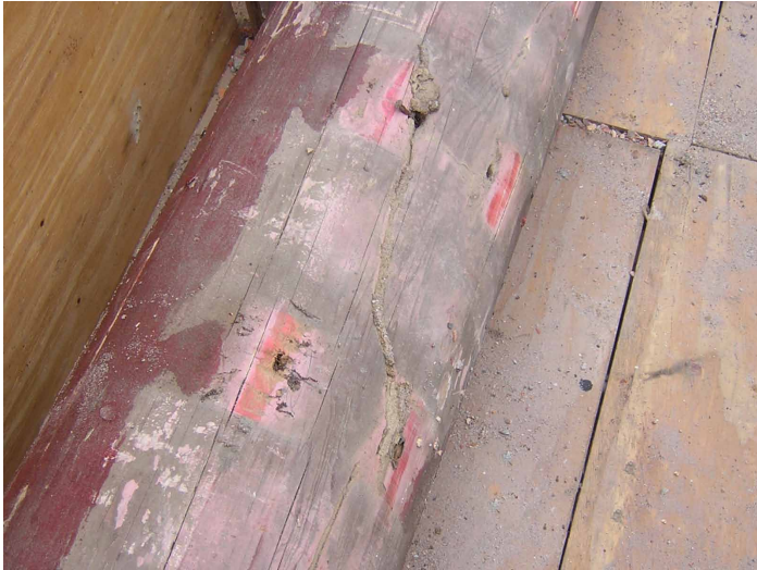
木標桁上的泥線
